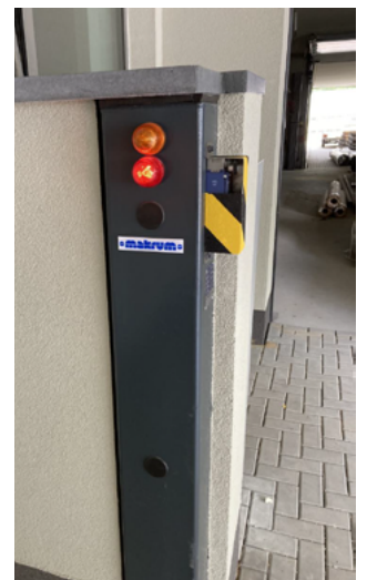
Widok na lampki ostrzegawcze, oraz wyłącznik krańcowy zamknięcia zapory.
