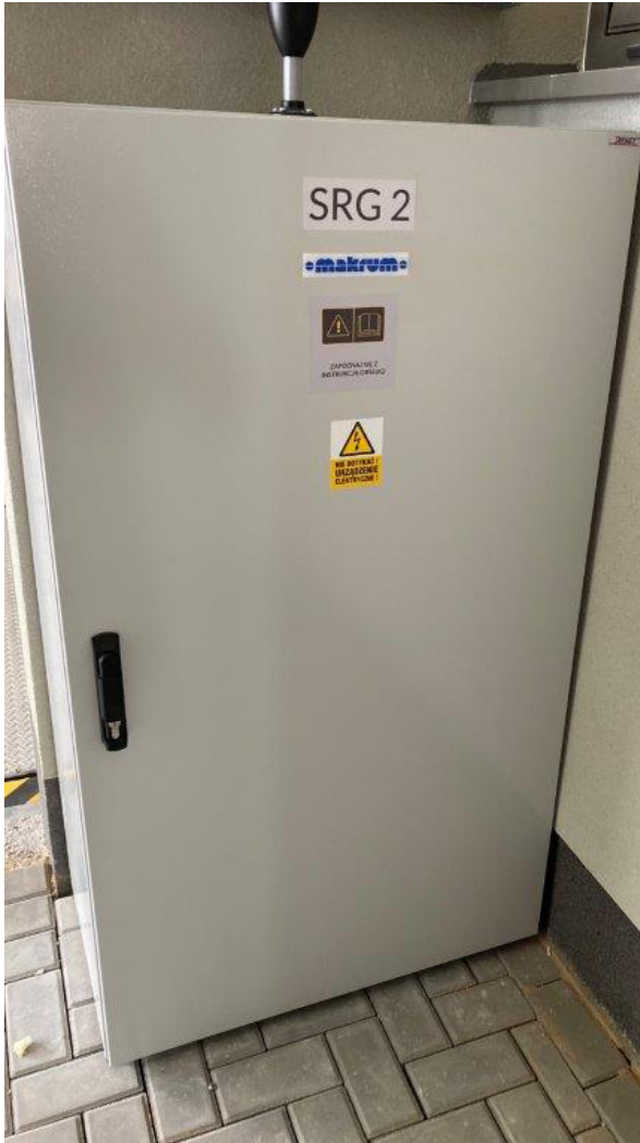
Szafa główna SRG wraz z osłoną zakrywającą przewody dochodzące z budynku.
