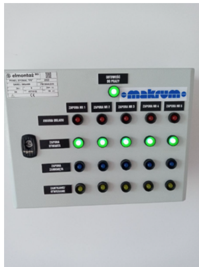
Szafa kontrolna w pomieszczeniu BMS w stanie gotowości zapór
