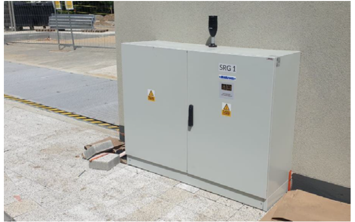
Szafa stalowa zawierająca agregat i szafę sterowniczą
